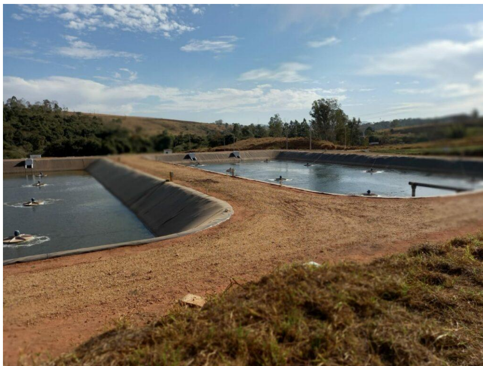
Figura 50: Estação de Tratamento de Esgoto de Caconde
