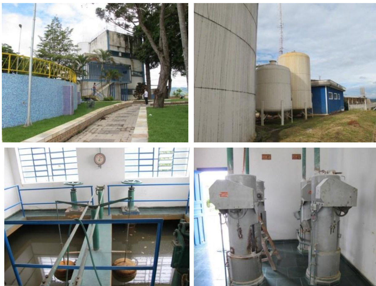
Figura 49: Acima ETA I e ETA II. Abaixo sistema de filtros da ETA I.
